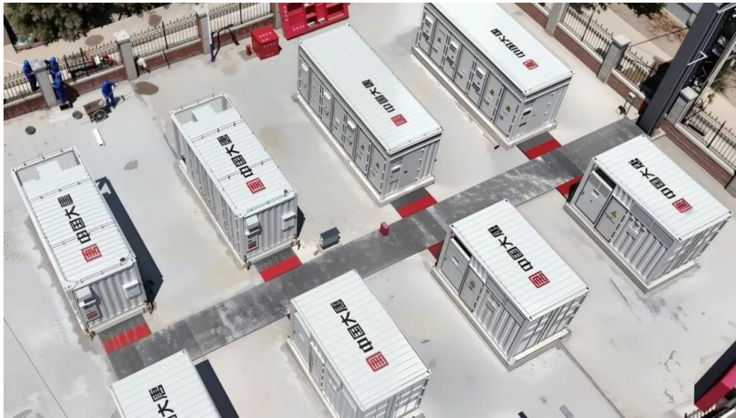
山东大唐鲁北火储联调项目图片
