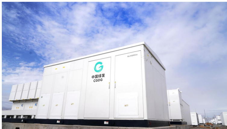
青海格尔木东岳储能电站150兆瓦/600兆瓦时构网型磷酸铁锂电化学储能系统
